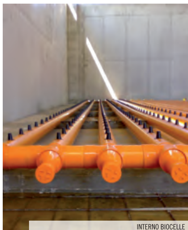
IMPIANTO TRATTAMENTO ARIA BIOSTABILIZZAZIONE
