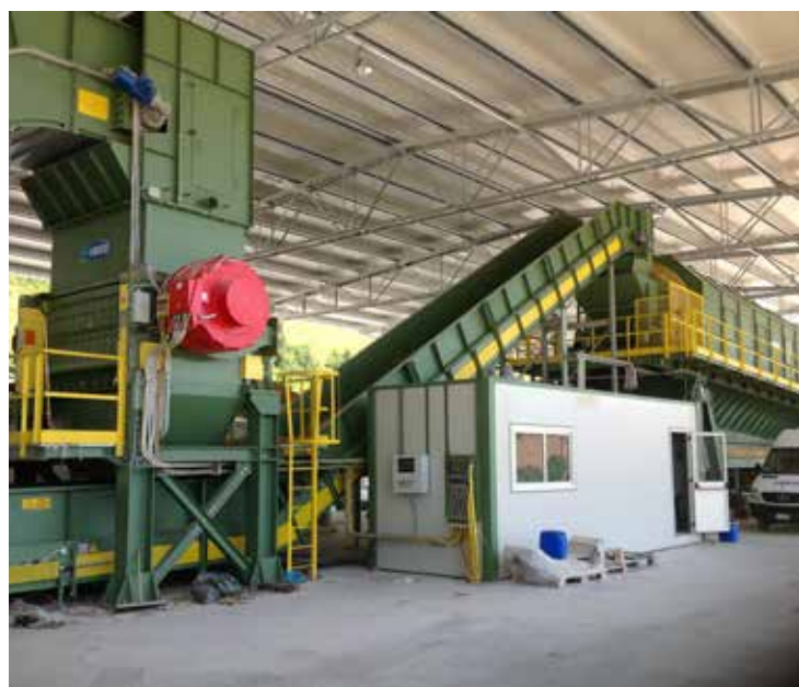
Impianto di selezione RSU 50-60 ton/h MSW sorting plant 50-60 ton/h
